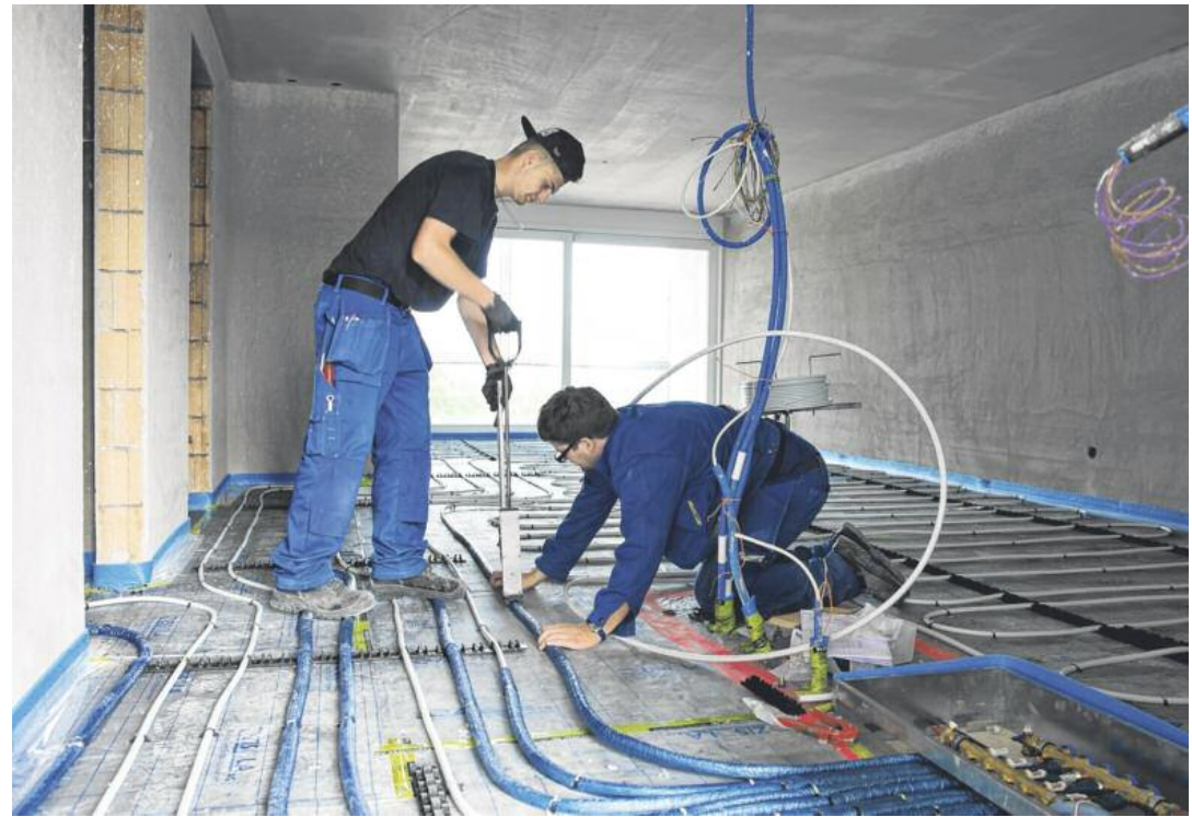
In den nächsten sieben Monaten erfolgt der Innenausbau, im Mai soll die Anlage bezugsbereit sein.
